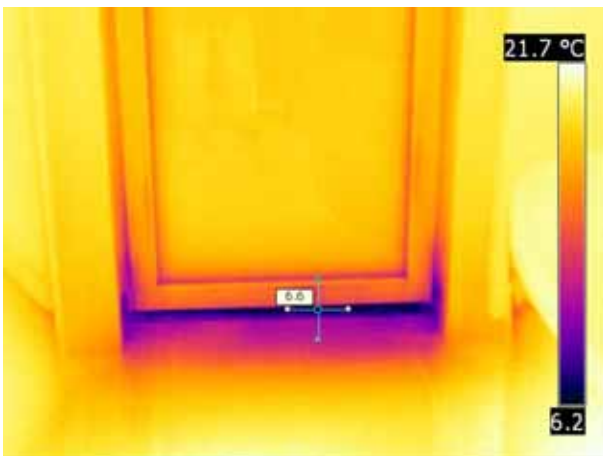
Terrassenfenster schließt unten nicht dicht
