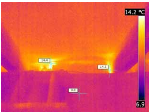
Sparrenfeld: Undichtigkeit zum Wohnbereich
